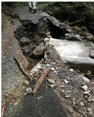
河岸侵食による道路崩壊
