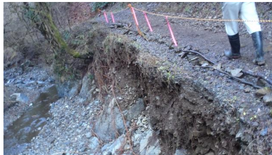
河岸侵食による護岸崩壊
