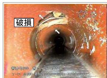
図1-8 下水道老朽管の破損
