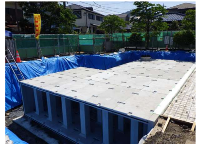
図3-7 浅川事務所駐車場の地下に設置されている大型雨水貯留浸透施設
