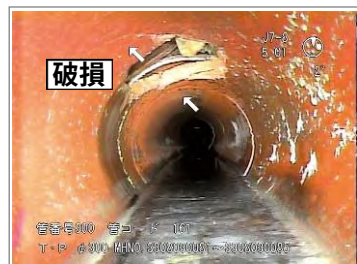
下水道老朽管の破損
