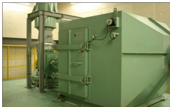
③活性炭吸着式脱臭装置
