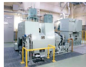
蒸気タービン発電機
