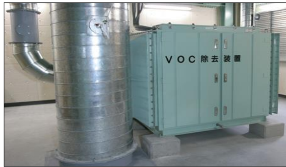
②VOC除去装置
