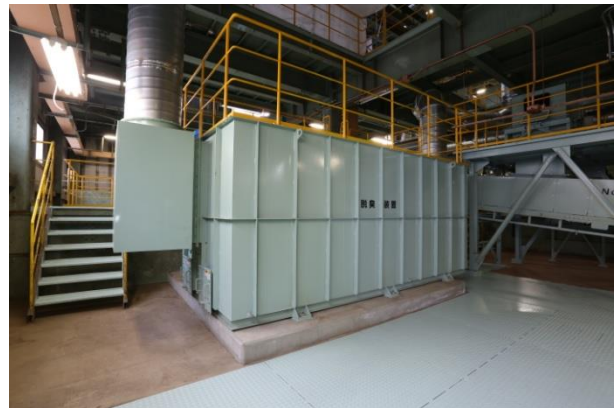
②脱臭装置
