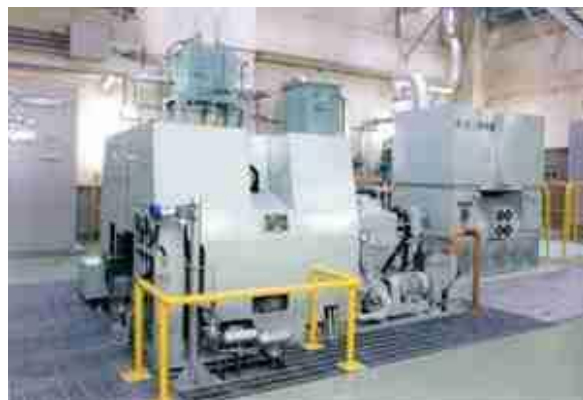
蒸気タービン発電機
