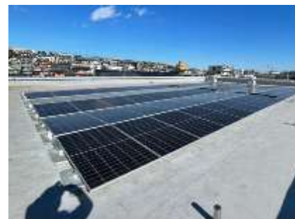
由井市民センターに設置した 太陽光パネル
