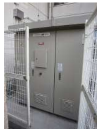
城山中学校の蓄電池 (過去の工事例)
